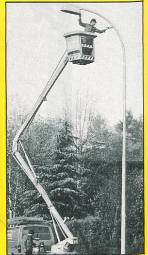
Korrosionsschutz an Stahlkandelabern
