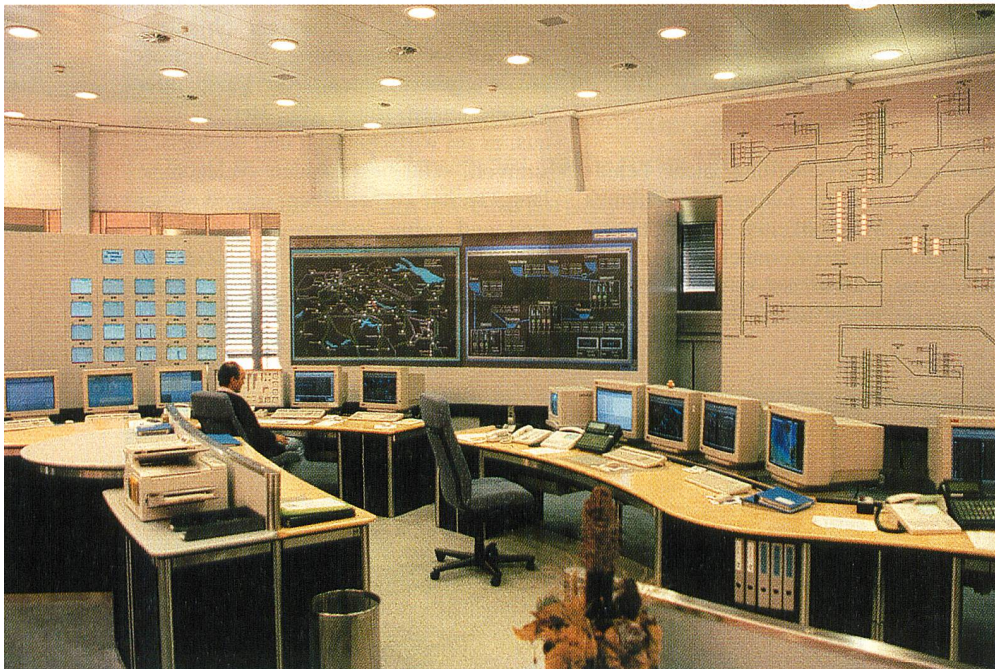
Bild 1 Die Energie- und Netzleitstelle der NOK in Baden.
