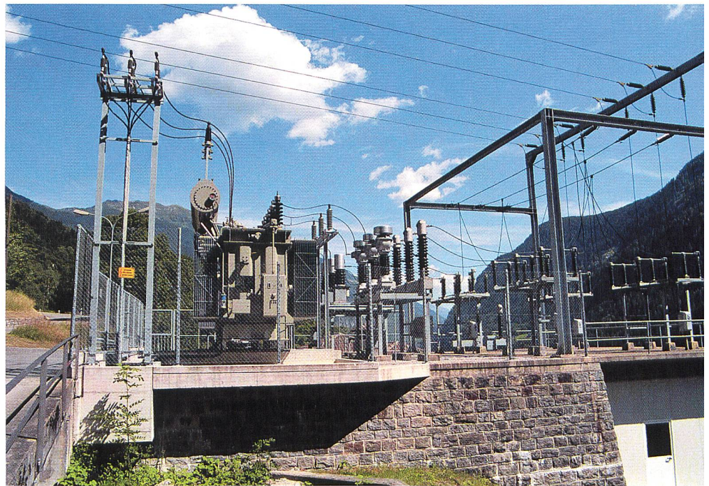
Bild 4 Unterwerk Faido, heute Anspeisung für die Baustromversorgung, später Anschluss für eine Mittelspannungs-Haupteinspeisestelle (Quelle: AlpTransit Gotthard AG).
