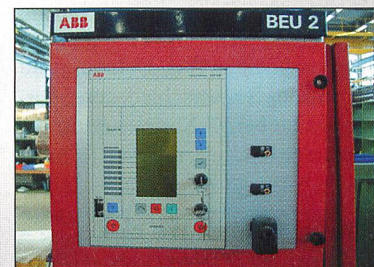
Engineering von Schaltanlagen
