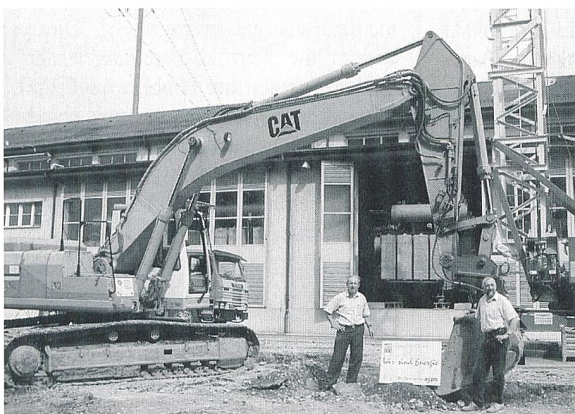
Architekt Hauri, Suhr, und AEW-Projektleiter Roth im Dienste der Stromversorgung. Im Hintergrund das alte Unterwerk (Bild: AEW).
