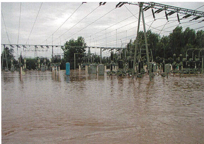
Überschwemmtes Umspannwerk in Sachsen (Bild enviaM).
