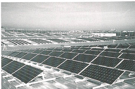
PV-Dachanlage auf der Münchner Messe.
