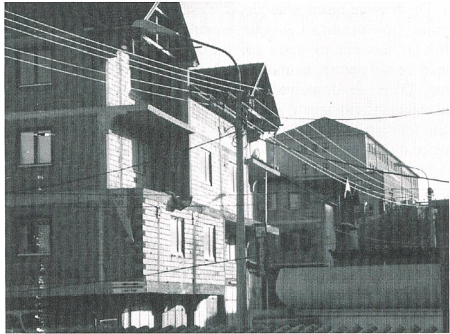
Fig. 3 Réseau aérien basse tension Un réseau un peu embrouillé et surchargé (Gjiilan)
