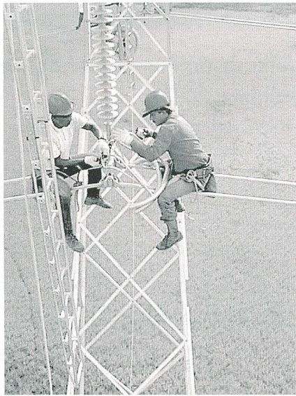
Verstärkung der grenzüberschreitenden Stromleitungen dringlich (Bild Alstom).
