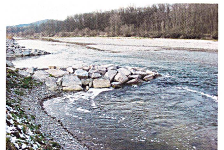
Buhnen Thur: Eine Ufersicherung durch Buhnen schafft vielfältige Strömungsverhältnisse im Gewässer und damit neue Lebensräume für Fische und andere Wasserbewohner. (Bild: Schälchli, Abegg und Hunzinger)
