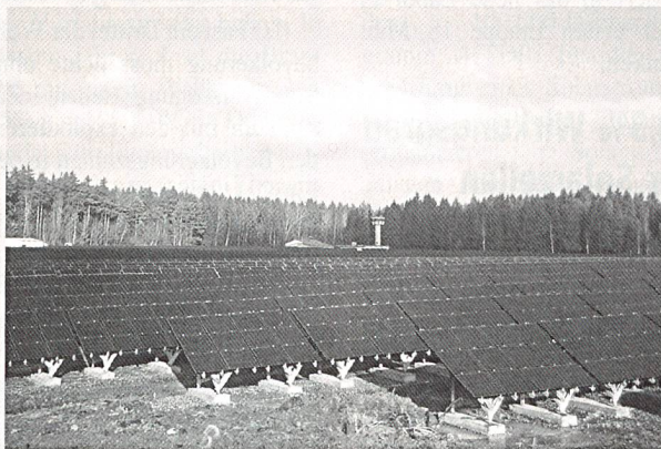
Weltgrösster Solarpark (4 MW) in Hernau (D).
