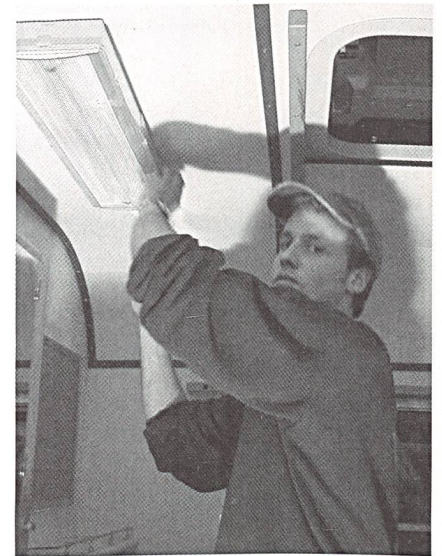
Stromversorgung in neuen Zirkuswagen: eine typische Arbeit in der Winterpause für Markus Bühler und seine Kollegen.
