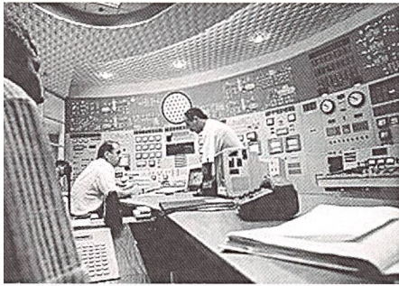
Kontrollraum im KKW Kosloduj.
