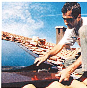
Solartechnik fachgerecht installiert.
