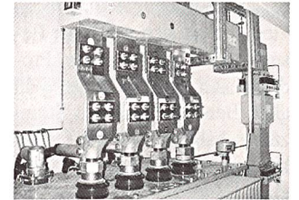
Trafoanschluss mit Lanz-HE-Übertragungsstromschienen
