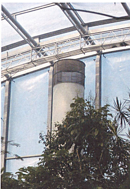
Der Ansaugstutzen «Ariane», der oben beim First der Masoala-Halle die überschüssige heisse Luft absaugt, leitet diese nach unten und führt sie dem System für die Wärmerückgewinnung zu.
