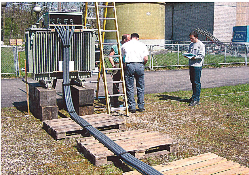
Bild 1 Messaufbau bei FKH/Däniken für 630-kVA SR-Transformator mit gebündelter US-Anspeisung.
