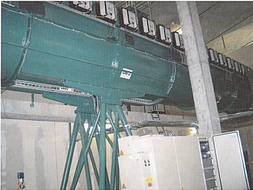
Blick hinter die Kulissen der Nautilus-Anlage
