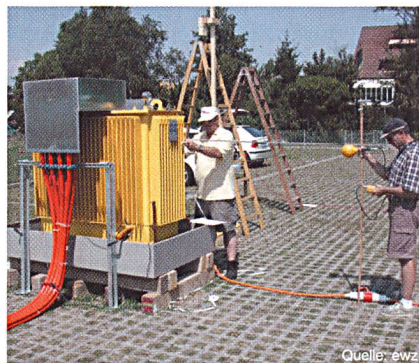
Bild 3 MS/NS-Transformator mit Anschluss-Abschirmhaube über dem NS-Kabelanschluss. Das magnetische Feld wird von den ESTI-Prüfern ausgemessen
