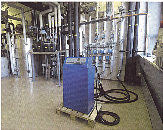
Im neuen Wärmepumpentestzentrum am NTB in Buchs werden die Geräte auf Herz und Nieren getestet (Bild IWP).
