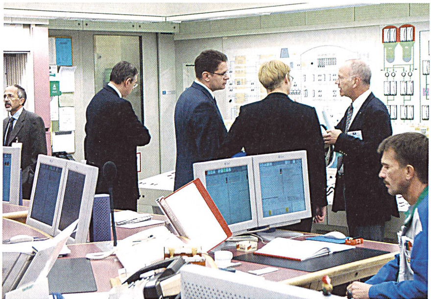
Die Besuchergruppe, darunter der Chef der obersten russischen Behörde für nukleare Sicherheit, GAN, Andrey Malyshev (Mitte), und Ulrich Schmocker, Direktor HSK (ganz links), lassen sich von Kraftwerksleiter Walter Nef (rechts) Einrichtungen im Kommandoraum des KKB erläutern (Bild: axpo).
