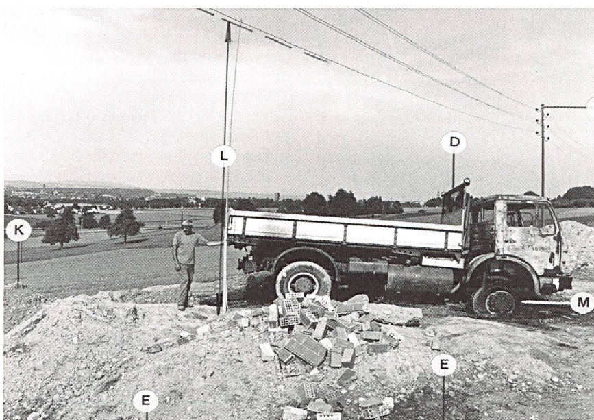
Zu kleiner Abstand zwischen Trassee und Freileitung, fehlende Kontrolle, unvorsichtige Arbeitsweise Distance insuffisante entre la chaussée et la ligne aérienne, absence de contrôle, manière imprudente de travailler
