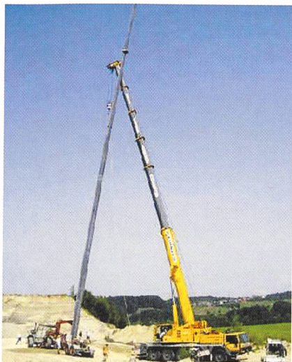
Der längste Betonmast der SAK mit einer Höhe von 45 Metern steht in Niederbüren (Bild: sak).
