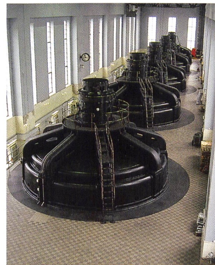
Chancy-Pougny: salle des machines avec les 5 groupes turbines-alternateurs actuels (photos: sfmcp)
