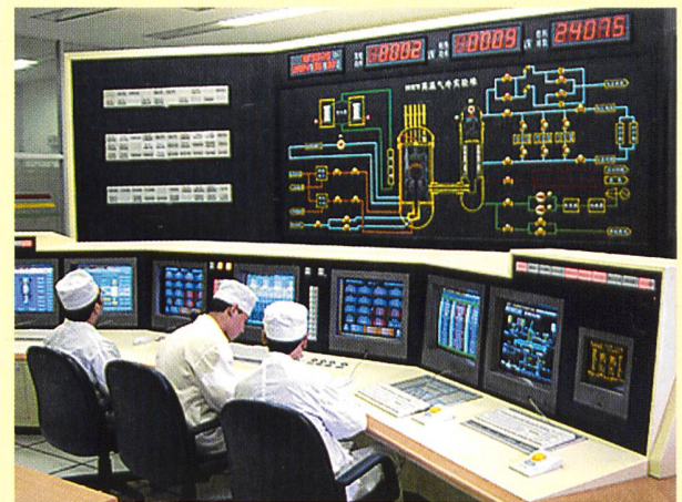
Kontrollraum eines gasgekühlten Versuchsreaktors an der Tshinghua Universität in Peking (Foto P. Pavlicek/IAEA).
