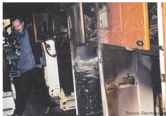
Figure 10 Vue de l'installation de couplage détruite
