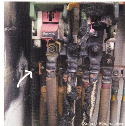
Fig. 6 Vue du lieu de l'accident
