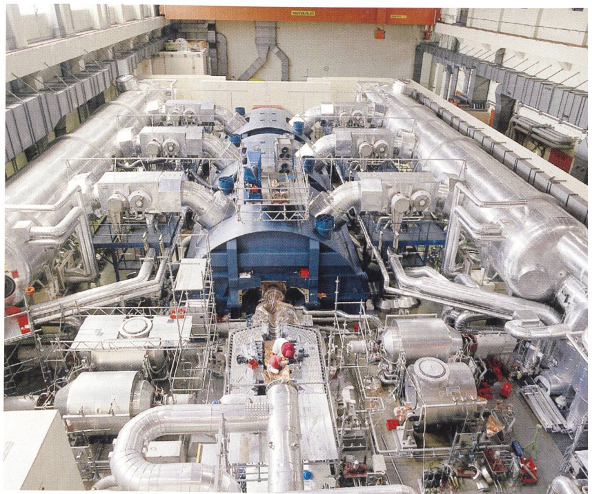
Das Kernkraftwerk Leibstadt erzielte 2003 mit total 9309 Gigawattstunden (GWh) einen neuen Produktionsrekord (Maschinenhaus).
