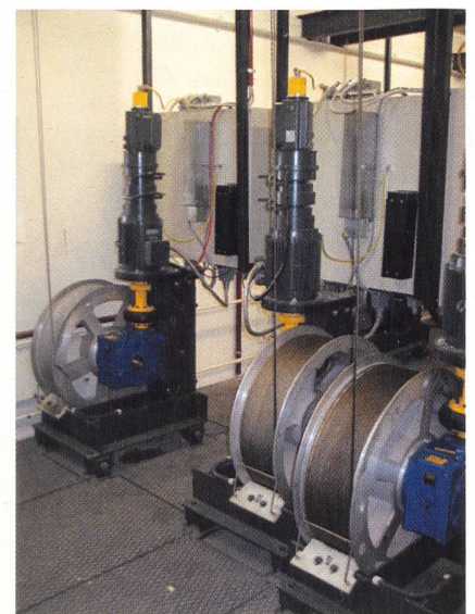
Die 90 Antriebe für die Prospekt- und Punktzüge werden über Computer angesteuert
