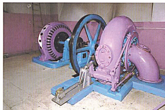
Intérieur de la centrale de Blanches Fontaines: Turbine Francis «Picard et Pictet» 125 kW et alternateur.
