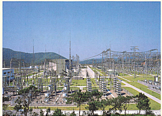
«Gui-Guang»-Stromrichterstation in Zhaoqing (China; Bild Siemens).
