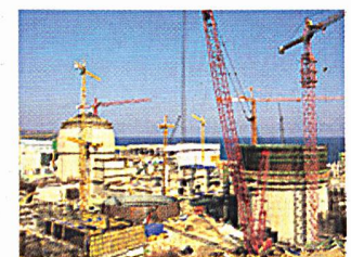
Vor allem in Asien werden neue Kernkraftwerke gebaut (im Bild KKW Ulchin 5 und 6 in Südkorea).
