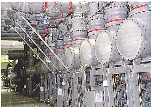
Gasisolierte Schaltanlage in einem Umspannwerk in Saudi Arabien (Bild Siemens).
