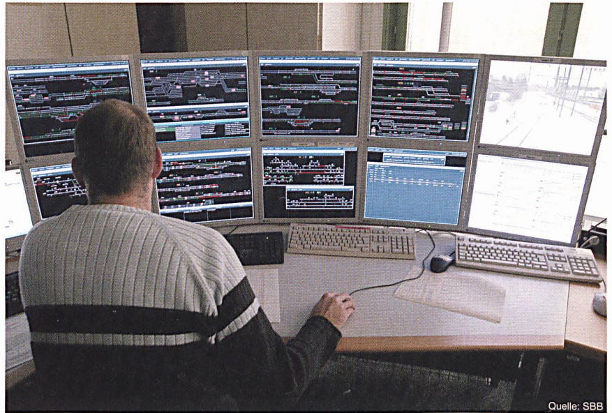
Bild 7 Fahrdienstleiter-Arbeitsplatz im Fernsteuerzentrum Olten (integrierte Leittechnik)
