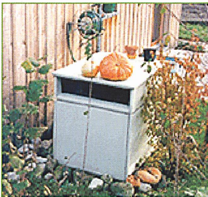
«Heizen im Einklang mit der Natur». Luft-Wasser-Wärmepumpe, Aussenauflistung (Bild FWS).
