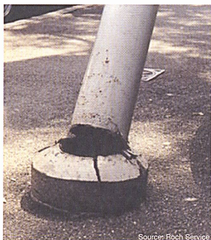
Figure 3 Fatigue et corrosion ont tendance à se développer dans les parties non visibles du fût
