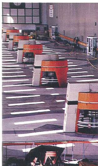
Wasserkraftwerk der Hidroelectrica (Generatorraum).
