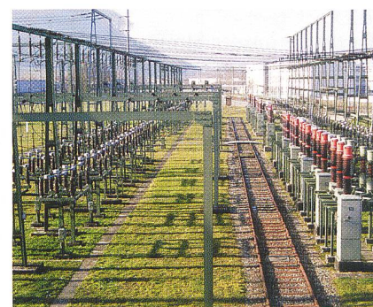
Alte Freiluftanlage soll durch eine Innenraum-anlage ersetzt werden (Bild: ebl).
