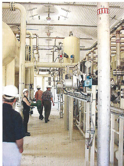
Intérieur du site à Weyburn.
