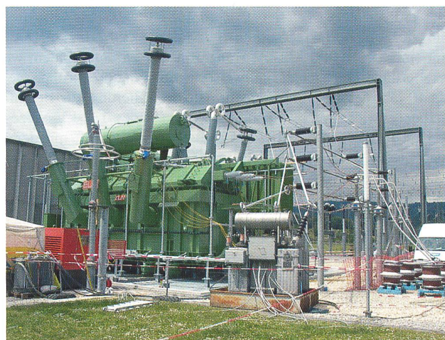
Bild 1 Netzkupplungstransformator mit Längs- und Querregelung in Bassecourt, hier bei der Hochspannungsprüfung nach der Montage
