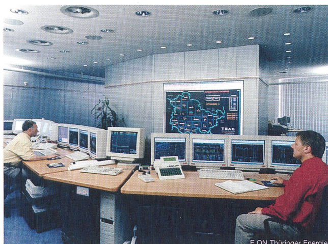
Bild 1 Das IT-System der Netzleitstellen gewinnt an Bedeutung.
