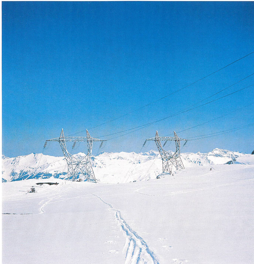
Stromnetze: Steigerung der Wertschöpfung bei Aufrechterhaltung der Versorgungssicherheit (Bild Axpo).
