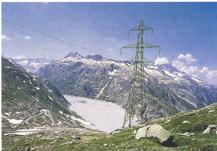
Stromleitung über die Grimsel: Auch die höchsten Hürden werden überwunden (Bild: vpe).
