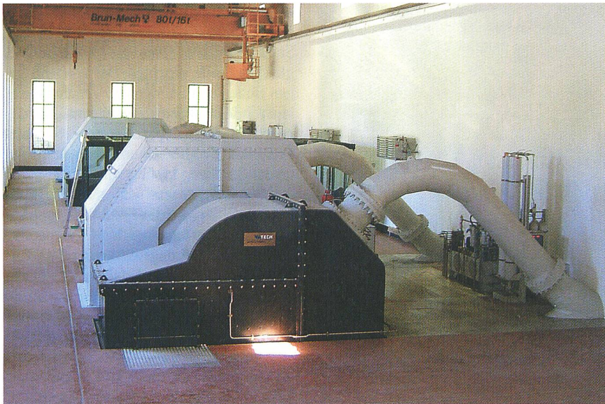
Die neuen Maschinengruppen im Kraftwerk Küblis produzieren jährlich 180 GWh Strom (Bild: Rätia Energie).
