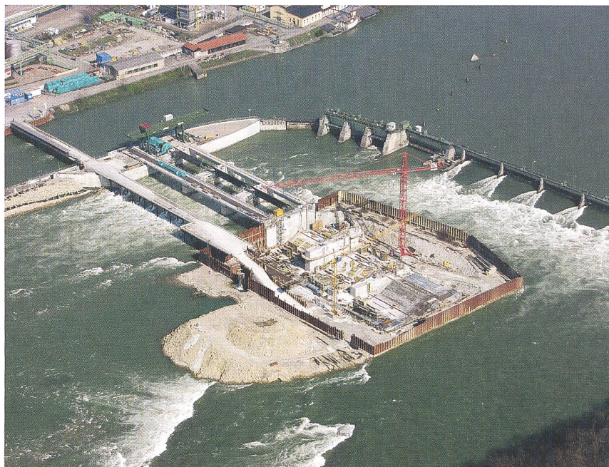
Die Baustelle für das neue Wasserkraftwerk Rheinfelden aus der Vogelperspektive (Bild: energiedienst).
