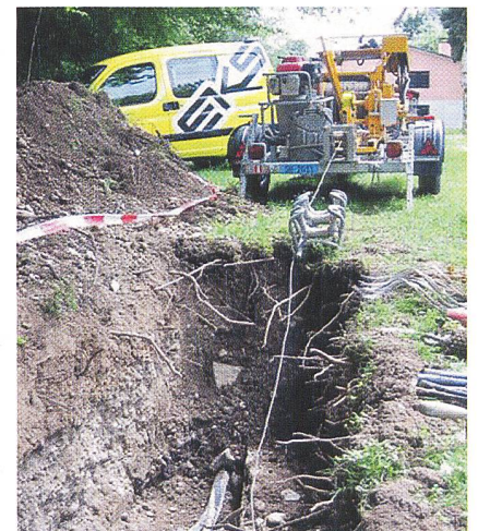
Eine der zahlreichen freigelegten Stellen, an der sich die Kabeltrasse abgesenkt hat (Bild: eks).
