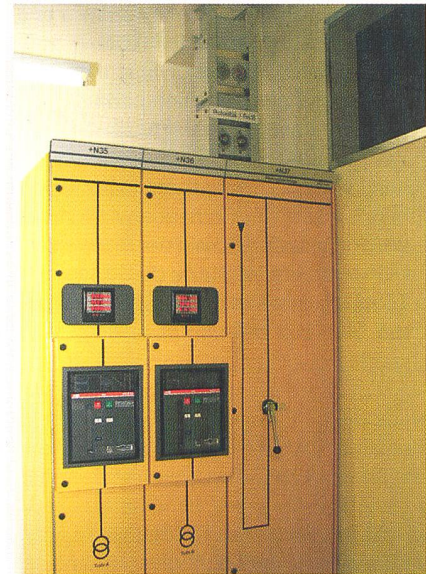
Hier wird die Energie der Fotovoltaikanlage via EWB ins Netz der BKW eingespiessen
