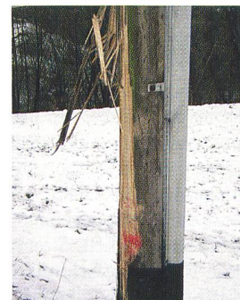
Beschädigte Stangen werden rot markiert (Bilder: ebl).
