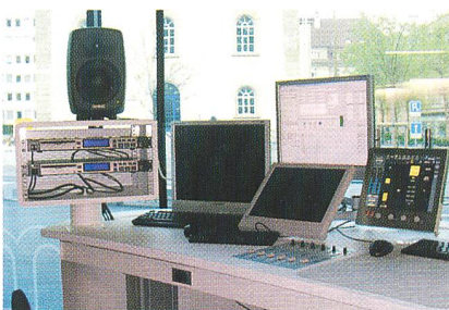
Mit dem System von Dätwyler stehen an jedem Arbeitsplatz durchschnittlich vier RJ45-Anschlüsse bereit
