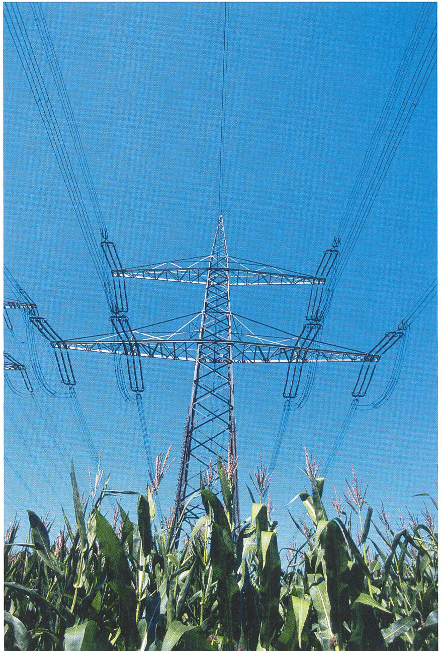
Auch der heisse Sommer brachte stark steigende Strompreise (Bild RWE).
