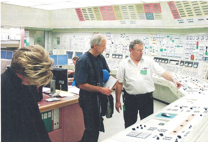
Die jährlichen Abstimmungen in der Beznau werden von Medienvertretern regelmässig genutzt, um sich ein Bild von den aktuellen Modernisierungen zu machen; hier interessiert die Erneuerung der Turbinen-Leittechnik und deren Instrumentierung im Kommandoraum (Bild: nok).
