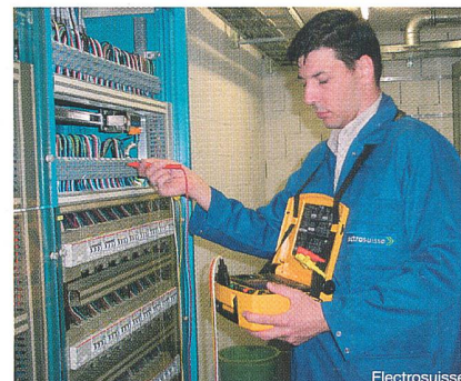
Bild 1 Schlusskontrolle nach der Niederspannungsinstallationsnorm
