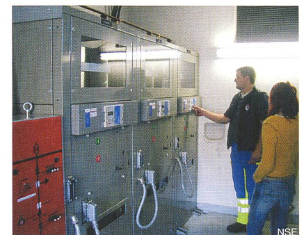
Bild 8 Gefahrlose Bedienung nach Modernisierung
